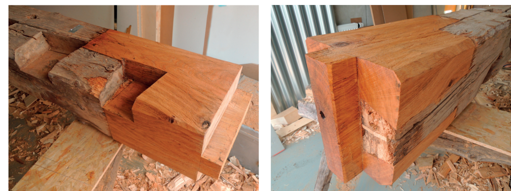
Obr. 2.3: A – Vložka sloupku roubené stěny osazena na svlak, B, C – Sloupek roubené stěny stodoly původně náležející ke usedlosti čp. 97 v obci Čistá u Litomyšle po dokončení vzorové opravy
