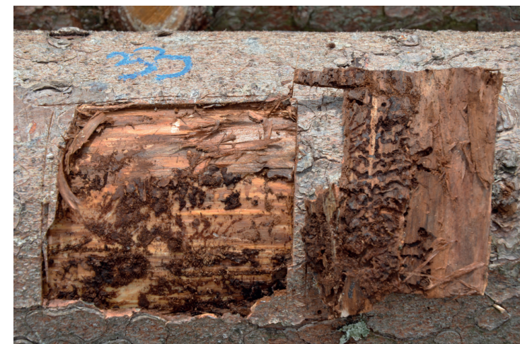
Obr. 3.23: Poškození kulatiny dřevokazným hmyzem – larvální chodby
