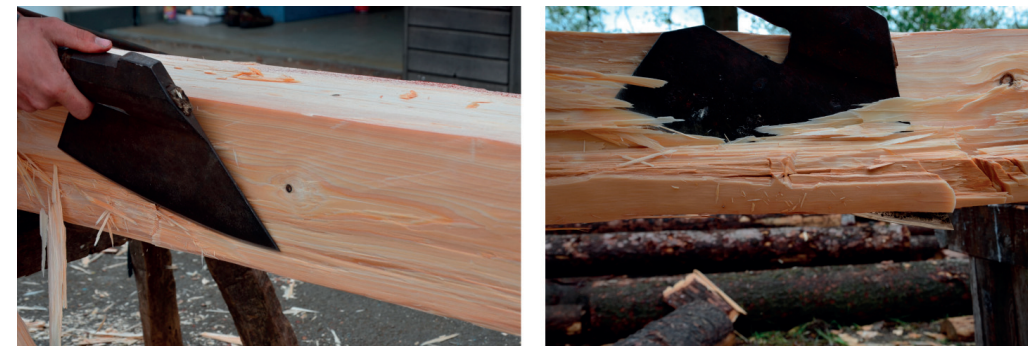
Obr. 5.3.24: Při nepříznivé točitosti má tesař nakloněnou sekeru na špičce, prosekává hranu a couvá
